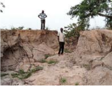
Eine der ausgespülten Stellen im Damm Foto: P.B. Hagen
